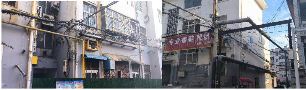
11、市场二楼墙面破损。
