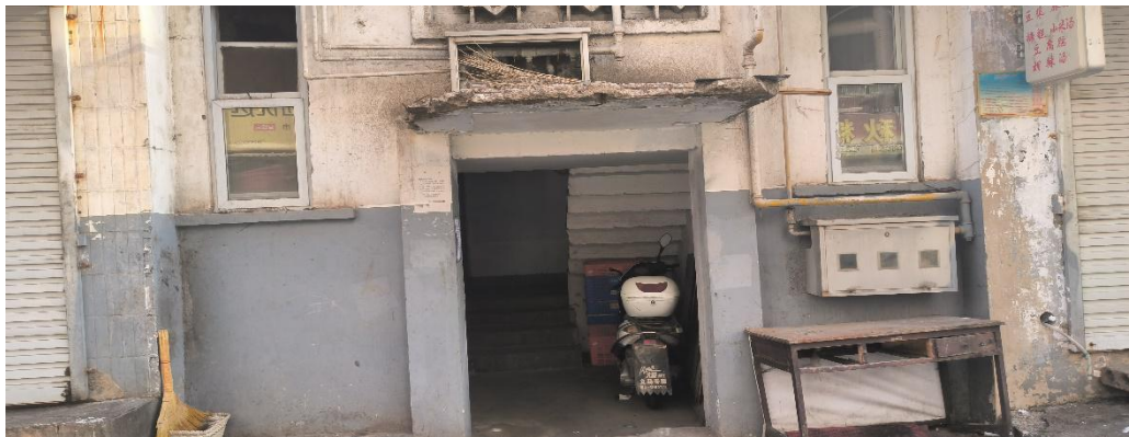
14、市场周边住房私搭乱建、墙壁破损，张贴广告。
