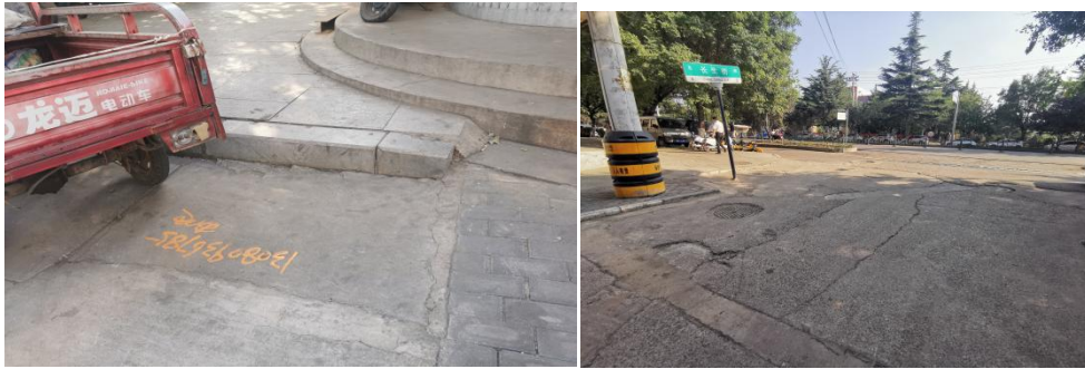
5、麻辣小厨门口 路面破损、坑洼。
