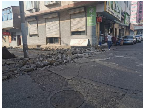
10、小亚改衣门口及南北两侧 路面破损、坑洼，车辆乱停放。
