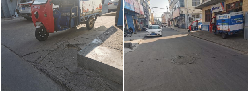
2、商务宾馆门口 路面破损、坑洼。
