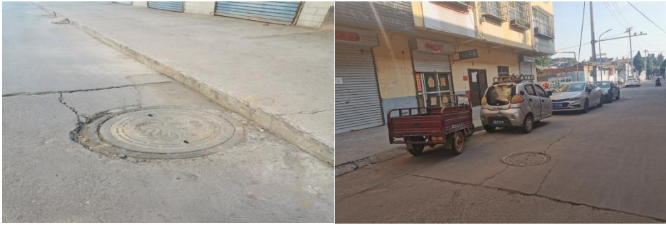
3、四小路口 路面破损、坑洼。
