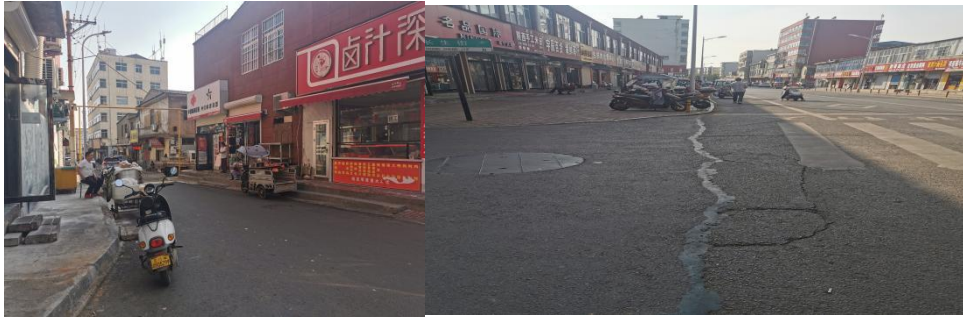
9、果十二门口 路面破损、坑洼，建筑垃圾堆放。
