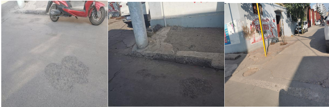
6、燕子小儿推拿门口 路面破损、坑洼。
